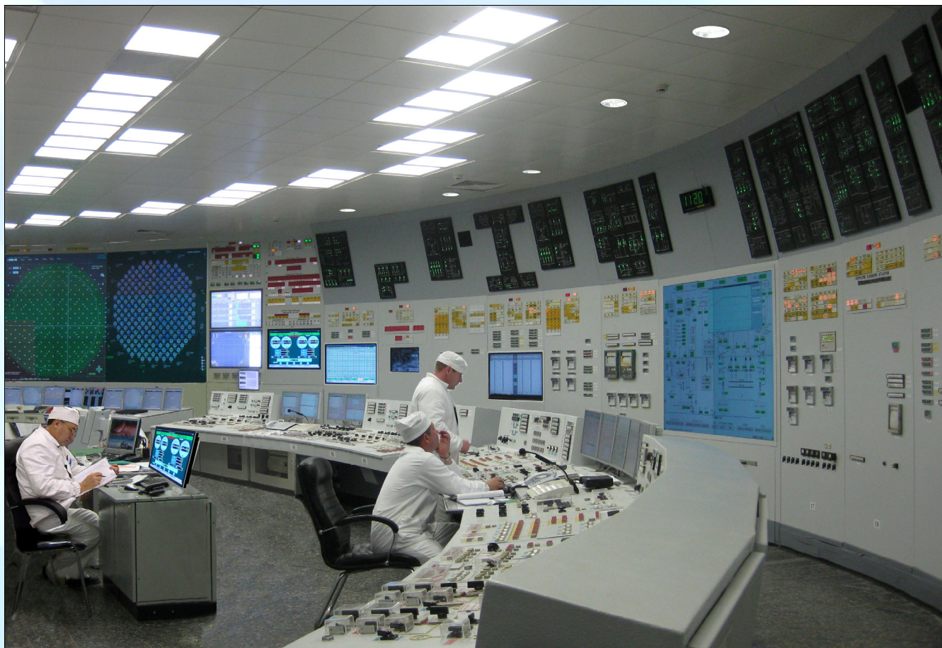
Блочный пульт управления энергоблока № 3 Курской АЭС
